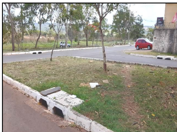
Foto 23. Drenagem de águas pluviais do SEE.
