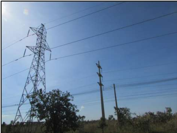
Foto 53: Rede Elétrica próxima ao empreendimento.
