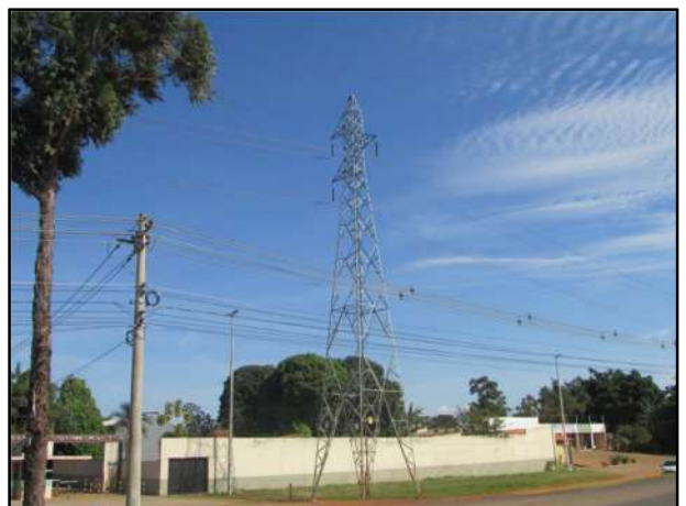
Foto 52: Rede Elétrica próxima ao empreendimento.
