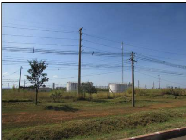
Foto 51: Equipamento Público Urbano (CAESB).
