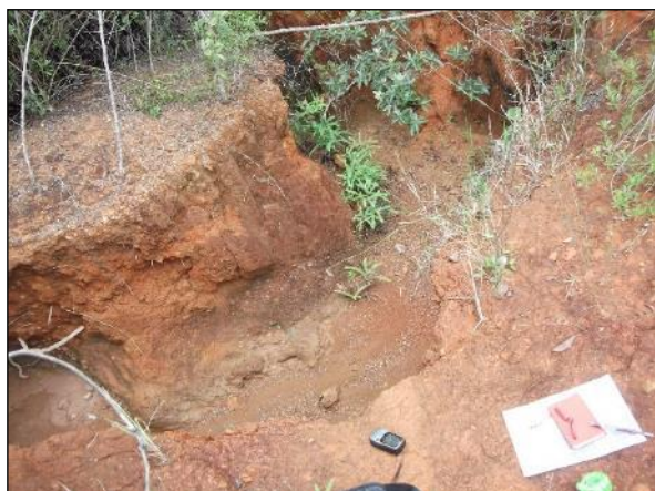
Foto 3.4: Erosão ocorrendo no canal de drenagem (UTM 204.428,00/8.248.527,00).
